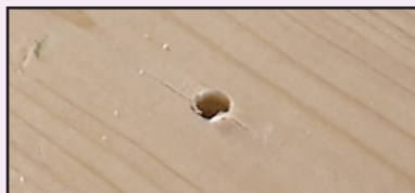
⑤抜き取ったビス穴も損傷が少ない。
