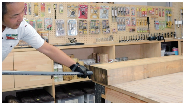
金物を通すが通らない！ 中心部分で穴がズレていることが原因
